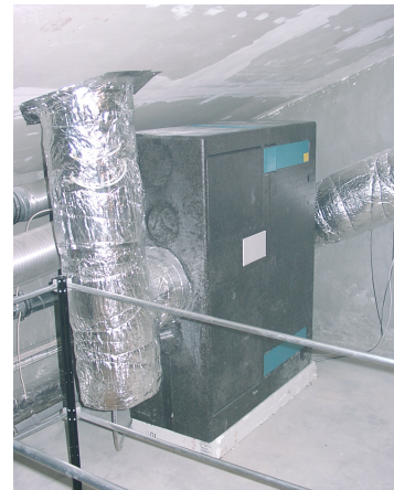
Figur 11 Isolerte kanaler, kilde: PHI
