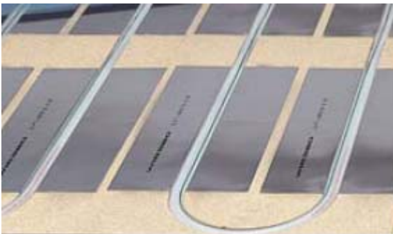
Figur 4.27 Vannbåren gulvvarme i sponplategulv (undergulv av spon)
