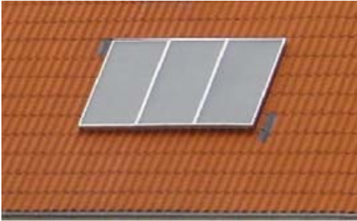
Figur 4.33 Vannbasert solfanger plassert på taket.
